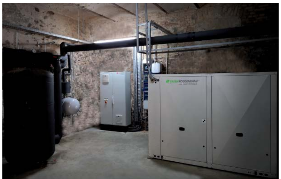
Abb. 1 Die neue Kältezentrale im ehemaligen Eiskeller (2018)
