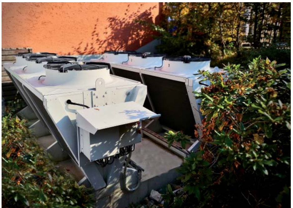
Abb. 2 Die Verflüssiger der neuen Kälteanlage (2018)
