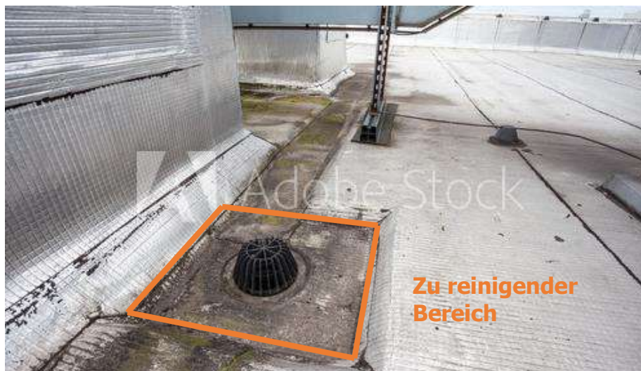
Abbildung 5: beispielhafter Dachablauf, ungereinigt
