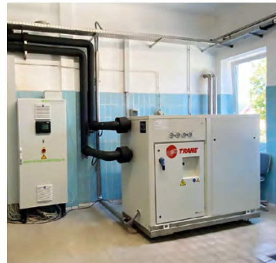
Die neu installierte Kältemaschine ergänzt das bestehende NH 3 -Anlagensystem. (Bild: Trane Roggenkamp)
