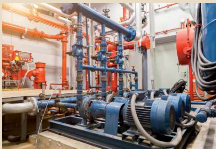
Durch einfache Maßnahmen lässt sich z. B. im Bereich der Pumpen viel Energie einsparen
