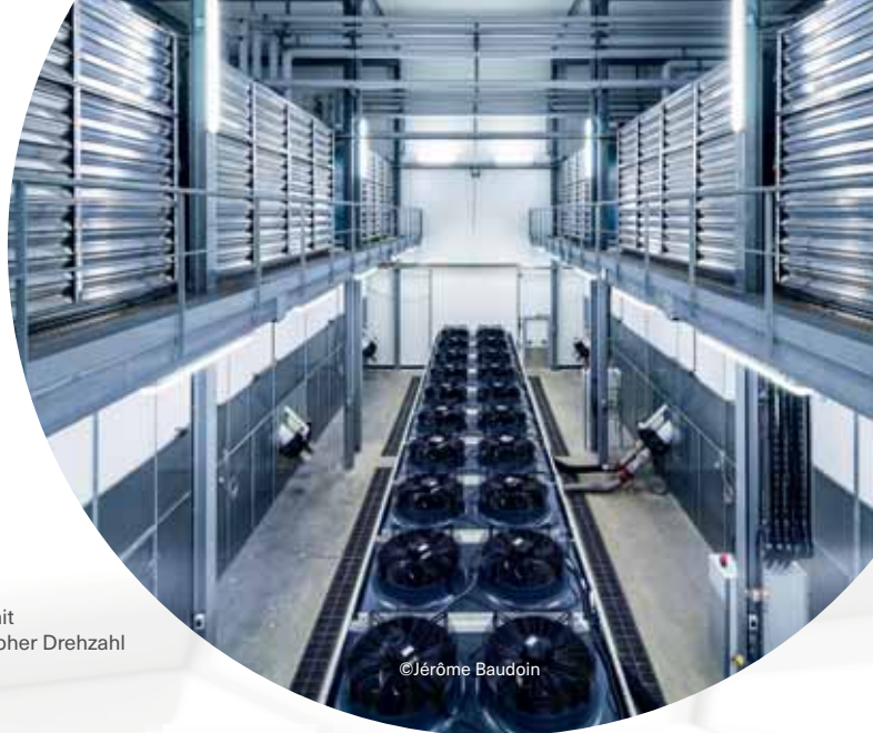
Trane Testanlage für luftgekühlte Maschinen in Charmes, Frankreich
